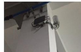
全车间无线覆盖
